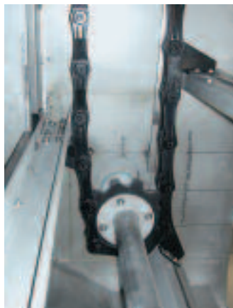
Schlammräumungssystem und Druckwasserversorgung
