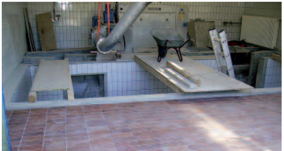
Neuer Anlagenstandort neben alter Rechenanlage
