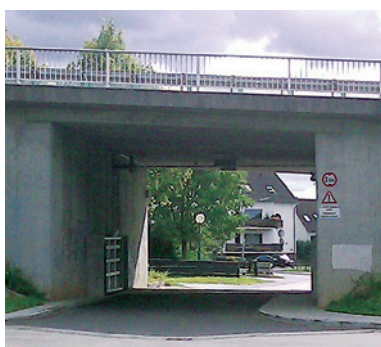
Brückenunterführung ohne Stemmtor
